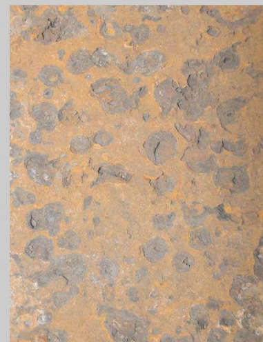
Локализованная коррозия при высоком содержании солей
